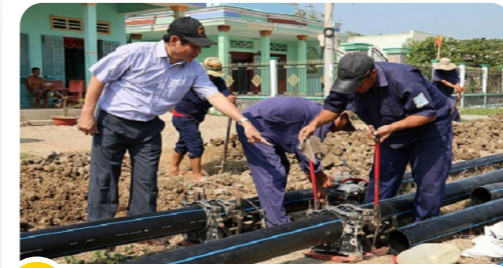
01 Cấp nước sinh hoạt H. Hiệp Hòa, Bắc Giang
